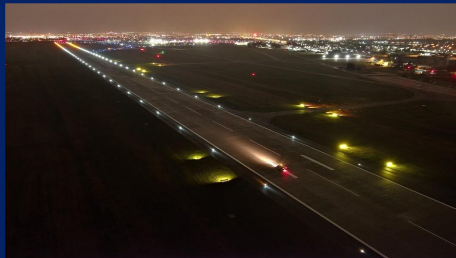
System oświetlenia nawigacyjnego
